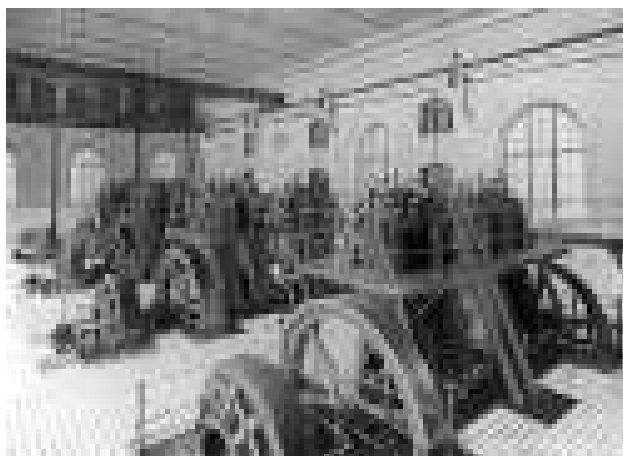
Рис. 15. Первая в России дизельная электростанция "Александровская" в Киеве была оснащена четырьмя дизелями. Введена в строй в 1904 г.
