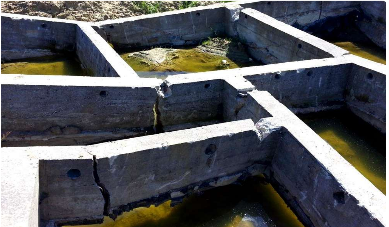
Рис. 15. Разрушение железобетонного фундамента вследствие морозного пучения
