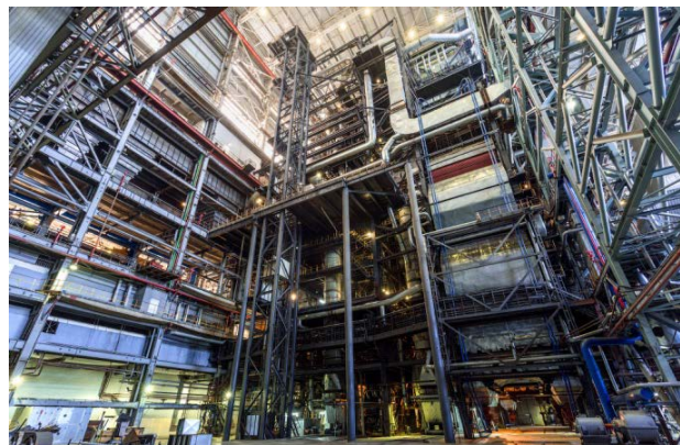
Котельное отделение. Вид снизу
