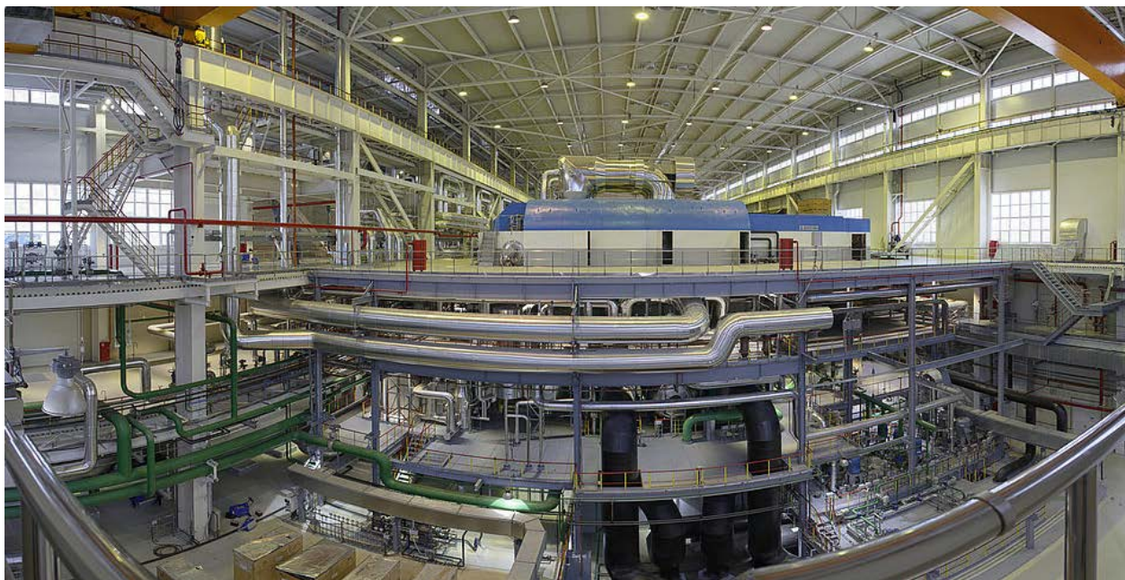
Рис. 49. Турбинное отделение на отметке обслуживания с поперечным расположением турбогенераторов. Правобережная ТЭЦ. Санкт-Петербург (ПГУ)
