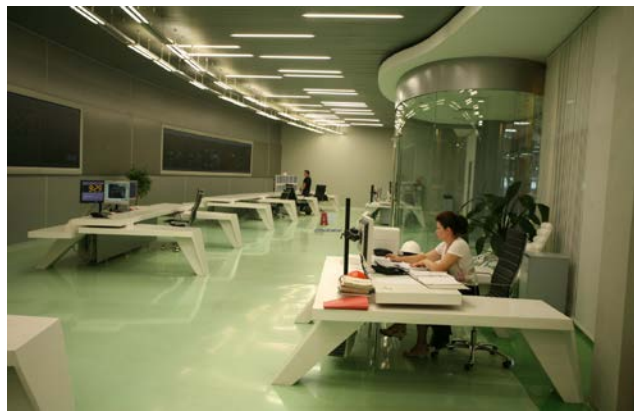
Рис. 59. Единый щит управления ТЭЦ-27 в Москве
