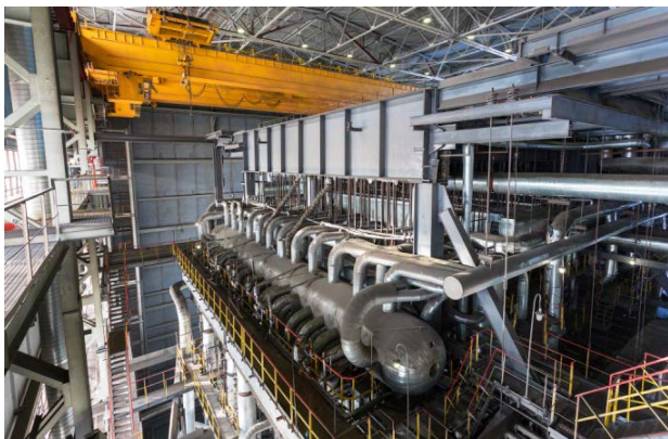
Горизонтальный барабан котла
