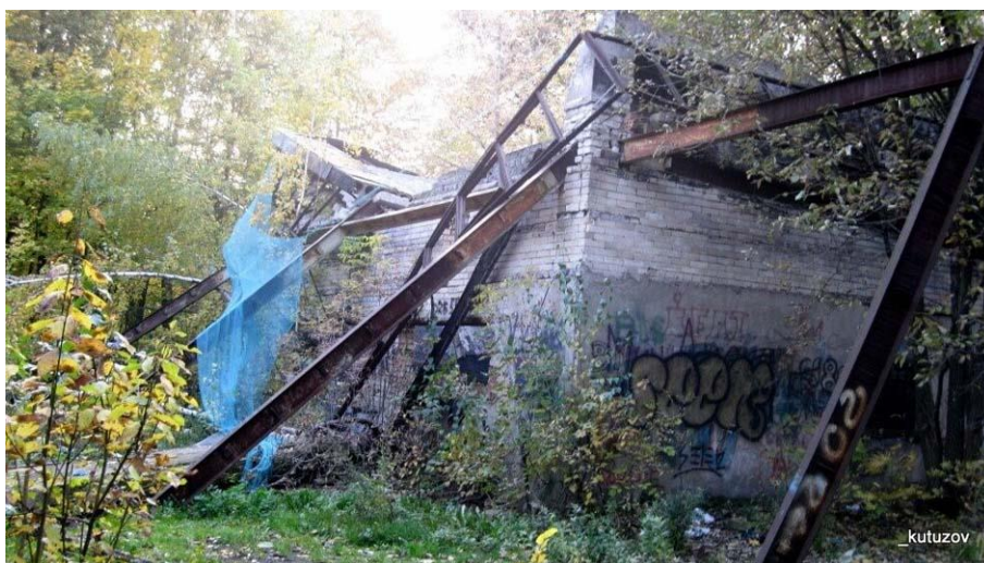
Рис. 8. Полуразрушенный ресторан в парке Сокольники. Фото второй половины 2000-х гг.
