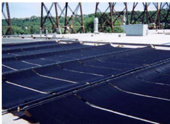
Рис. 1. Гибкие пластиковые солнечные панели на плоской кровле
