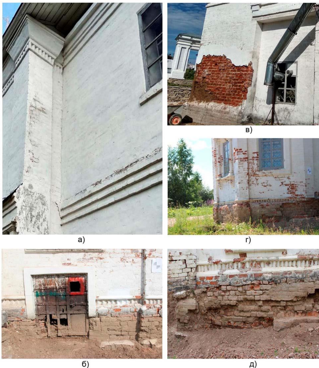
Рис. 6. Фотофиксация дефектов и повреждений (фото автора): а) трещина между притвором и трапезной; б) сквозная коррозия стальной двери в подвал; в) замачивание штукатурки и кирпичной кладки, разрушение штукатурного слоя; г) замачивание штукатурки и кирпичной кладки в уровне первого этажа, водоотвод не организован; д) разрушение кирпичной кладки цоколя, отсутствие отмостки
