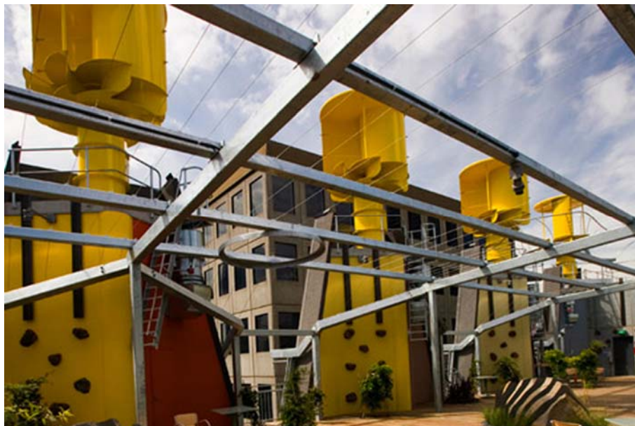
Рис. 4. Ветряные турбины на крыше Council House 2 (сертификат LEED)
